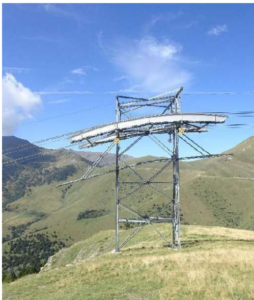
Ejemplo de torre de línea
