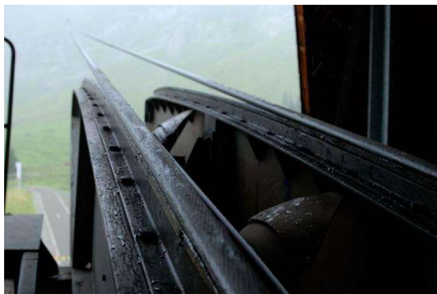
Visión de un par de “zapatas” guiando los 2 cables portadores a la salida de una estación.
