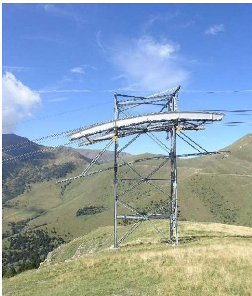
Ejemplo de torre de línea
