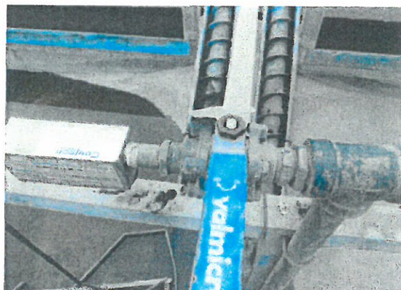
PRESENCIA DE OXIDO
