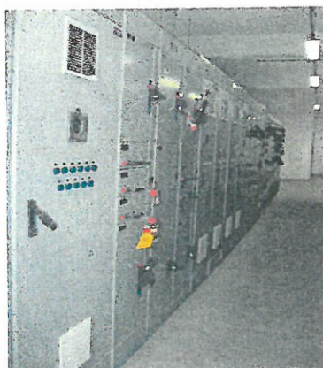
CENTRO DE CONTROL DE MOTORES (CCM-00-01)
