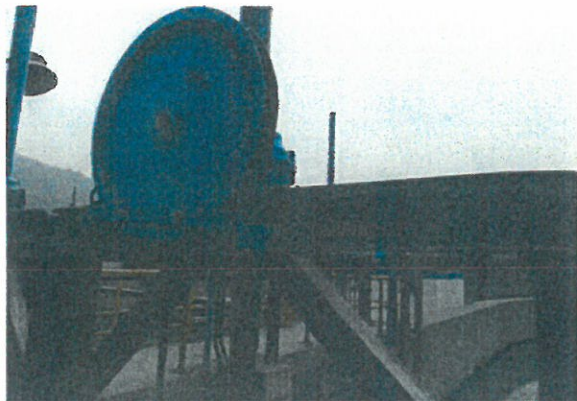
COMPUERTA MANUAL CP-10-01 B
