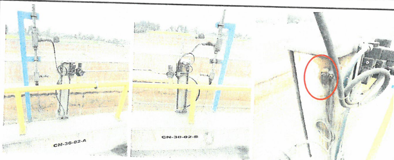
COMPUERTAS NEUMATICAS ENTRADA A FILTROS CN-30-02 A/B
