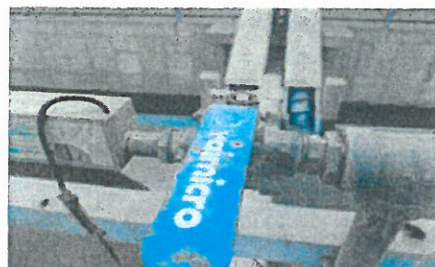
PRESENCIA DE OXIDO
