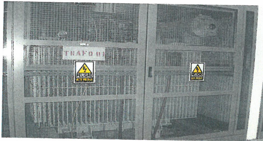
CELDA DE TRANSFORMACION 1
