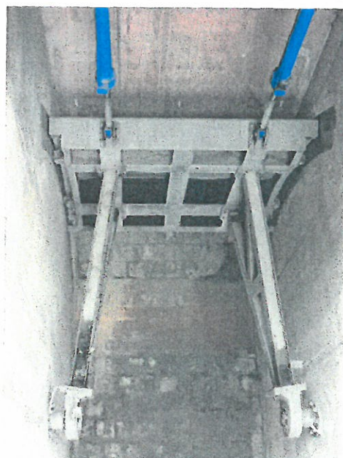
COMPUERTA RADIAL, BRAZOS DE IZAJE Y CILINDROS HIDRAULICOS
