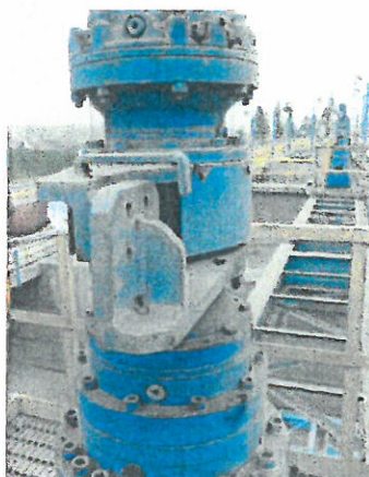
FALTA DEL SENSOR DE
