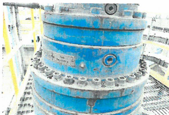
PRESENCIA DE OXIDO. PINTURA EN MAL ESTADO.
