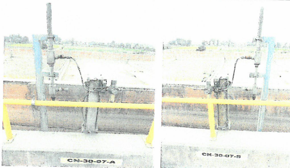
COMPUERTAS NEUMATICAS ENTRADA A FILTROS CN-30-07 A/B
