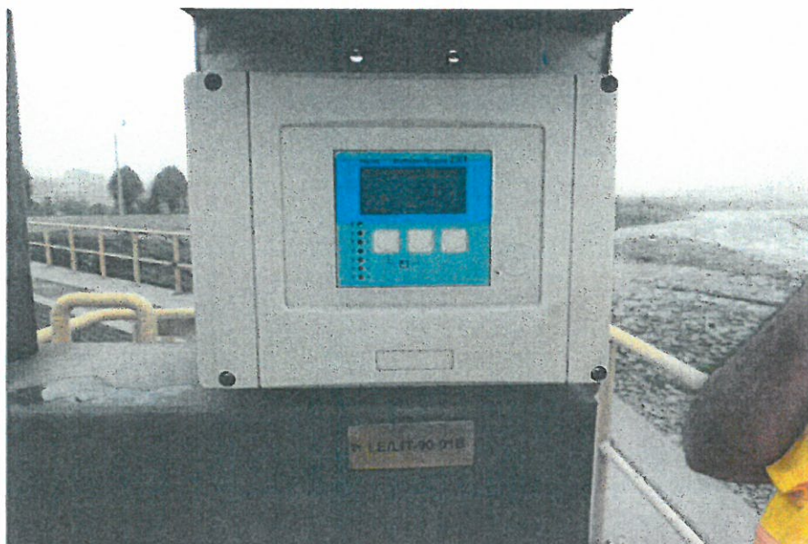
INDICADOR-TRANSMISOR DE NIVEL LIT -90-01 B
