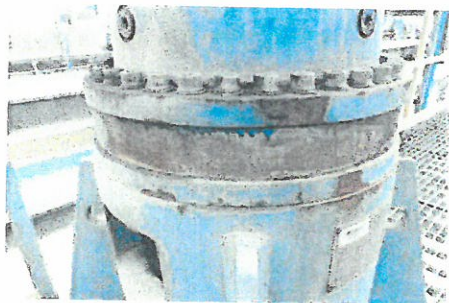
PRESENCIA DE OXIDO EN RASPADOR DE ARENA
