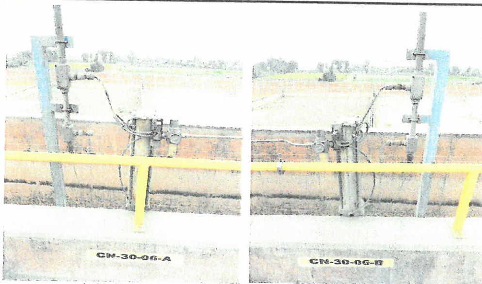
COMPUERTAS NEUMATICAS ENTRADA A FILTROS CN-30-06 A/B
