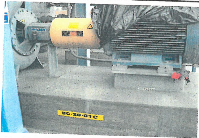
CONJUNTO MOTOR-BOMBA BC-30-01C
