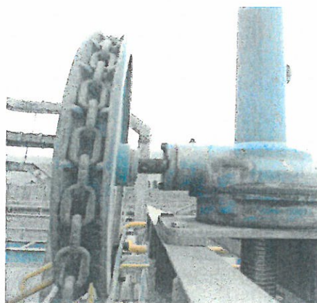
PRESENCIA DE OXIDO
