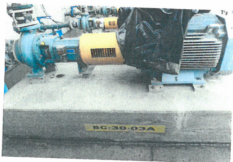
CONJUNTO MOTOR-BOMBA BC-30-03A
