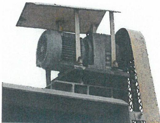
PRESENCIA DE OXIDO EN CARCASA DE MOTOR Y EN TUERCAS DEL SOPORTE
