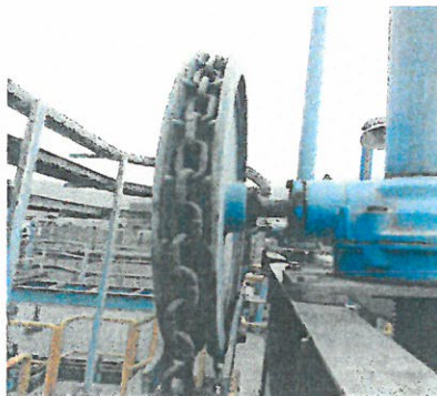
PRESENCIA DE OXIDO
