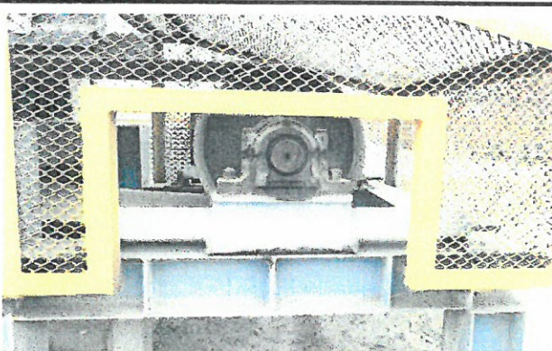
PRESENCIA DE OXIDO
