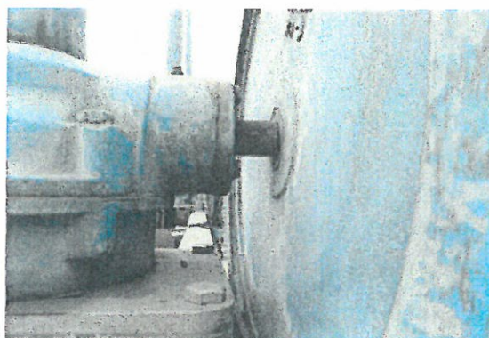
PRESENCIA DE OXIDO
