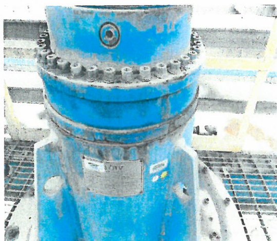
PRESENCIA DE OXIDO
