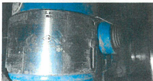
TRANSMISOR DE NIVEL LIT-30-18
