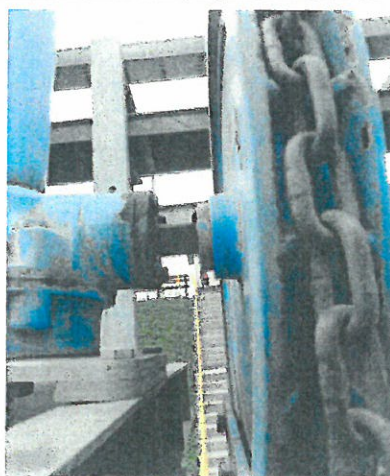
PRESENCIA DE OXIDO
