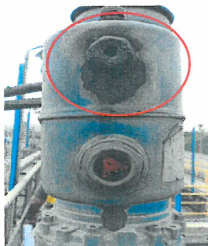
INDICADOR DE NIVEL DE ACEITE DAÑADO
