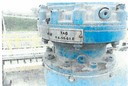
PRESENCIA DE OXIDO EN RASPADOR DE ARENA
