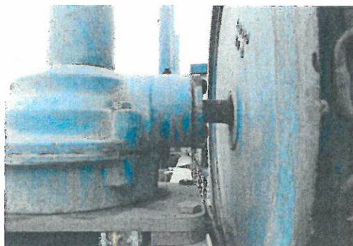
PRESENCIA DE OXIDO
