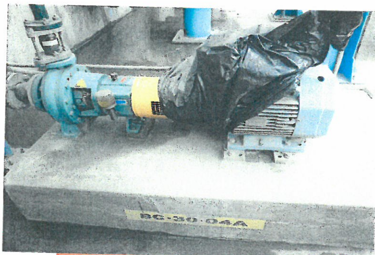
CONJUNTO MOTOR-BOMBA BC-30-04A
