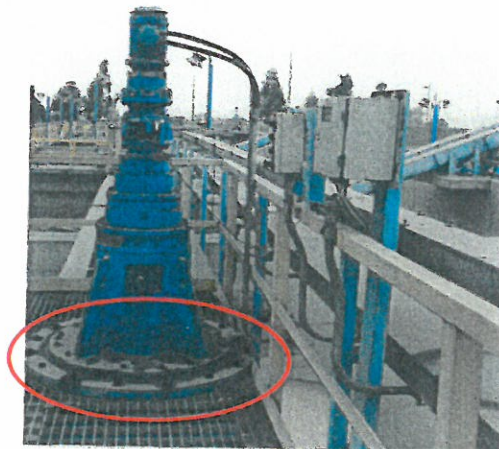
DETERIORO EN LA PINTURA Y FALTA DE LIMPIEZA DEL EQUIPO
