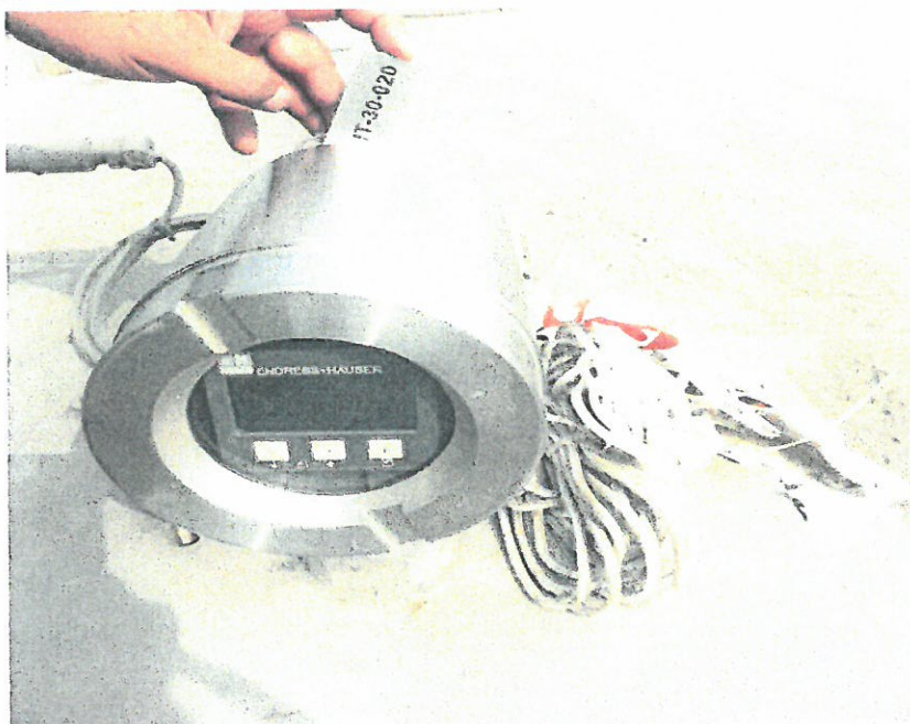
TRANSMISOR DE NIVEL RESERVORIO
