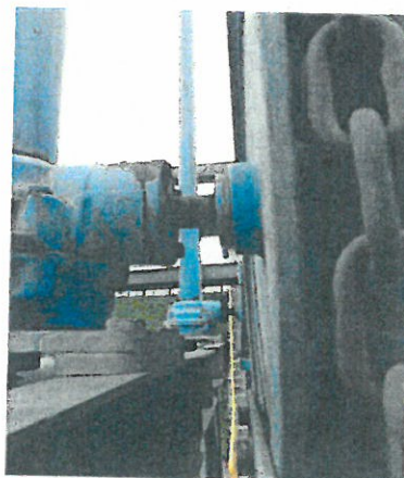
PRESENCIA DE OXIDO
