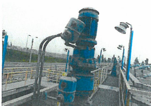
CORREGIR INSTALACION DE INDICADOR DE NIVEL DE ACEITE
