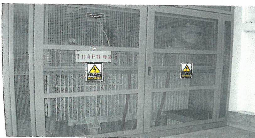
CELDA DE TRANSFORMACION 2
